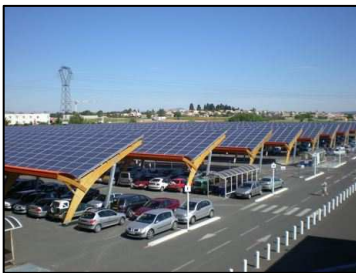
Panneaux photovoltaïques dans un parking de centre commercial
